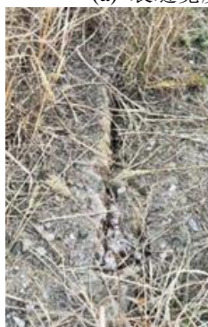
(b) 高低裂缝
