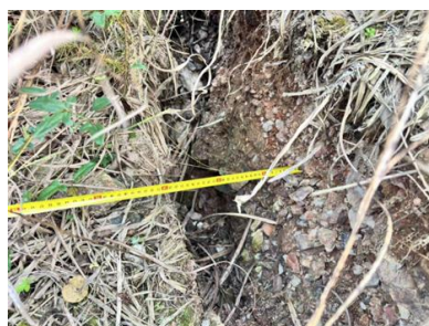
(a) 裂缝宽度
